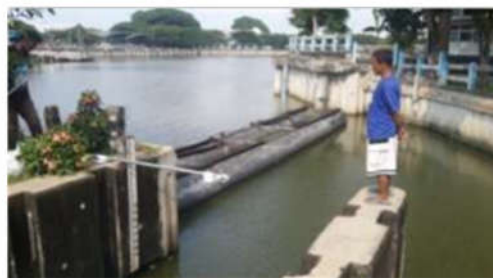
Sensor dan Tiang Penyangga
